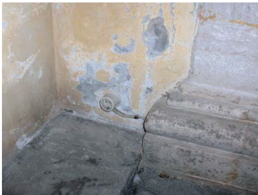
Fig. 34 Degradação, junto a uma tomada eléctrica, do revestimento de uma parede provocada pela humidade
