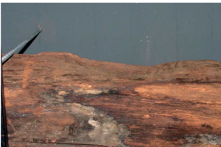
Fig. 116 Pormenor de um objecto em madeira danificado pela acção de fungos
